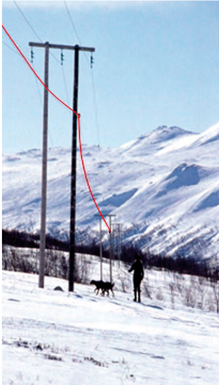
Kraftledning med underliggende jordline markert med rødt.
