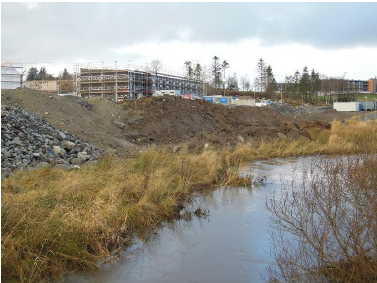
Figur 8.3. Eksempel på dårlig massehåndtering ved utbygging av nytt boligområde, her ved Sørbøhagene. Masser er lagret tett opp mot Høylandsåna (straks oppstrøms Stokkalandsvatnet) uten noen form for sikring mot avrenning til vassdraget..
