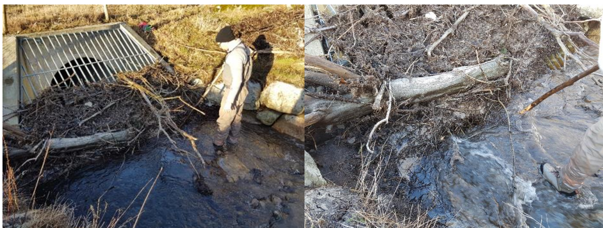
Figur 11.9. En ansamling av greiner og finstoff tettet vandringsveien for fisk i Melsheibekken fullstendig. Vannstanden sank raskt med 25 cm da «sperringen» ble åpnet ved undersøkelsen i januar 2017.
