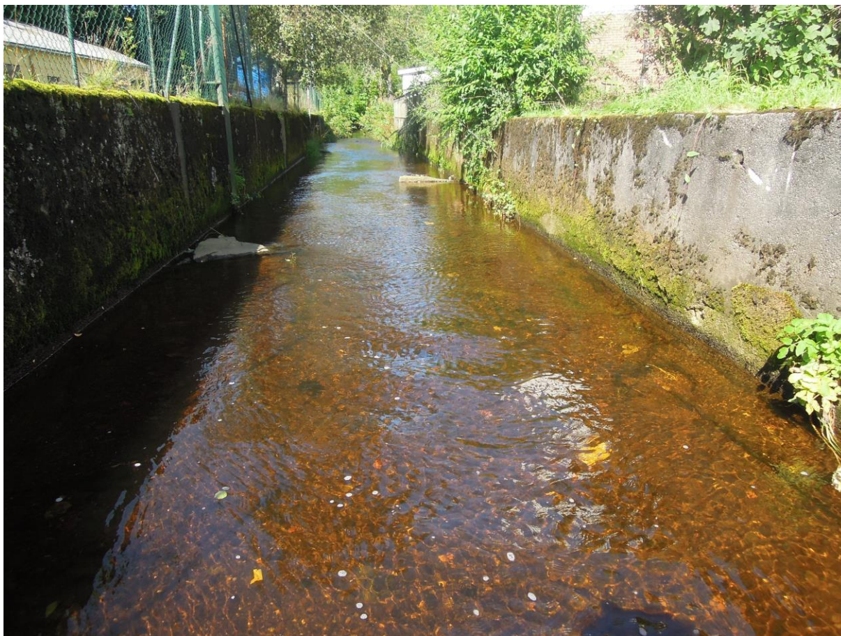
Figur 18. Deler av Høydalsbekken er kanalisert, her fra nedre del. Foto: Rune Søyland
