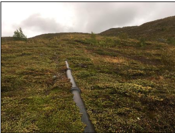
Figur 9. Eksisterende rørgate ligger grundt og flere steder oppe i dagen. Traktorvei til inntaket ses oppe til høyre på bildet. Foto: Bjarne Homnes Oddane
