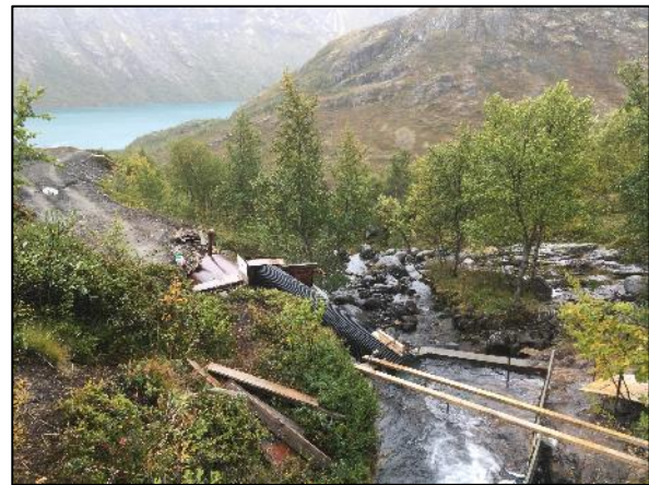
Figur 10. Eksisterende inntak i Hestbekken. Foto: Bjarne Homnes Oddane
