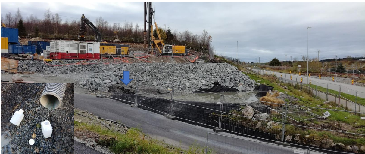
Figur A2. Sedimentasjonsdammen på riggområdet er tilkoblet avskjæringsgrøft fra riggområdet (pil). Damutløpet er foreløpig stengt, og vannet har jevnlig blitt tappet ut med sugebil (14.11.17). Rensekontainere tilkoblet boreriggene ses til venstre.
