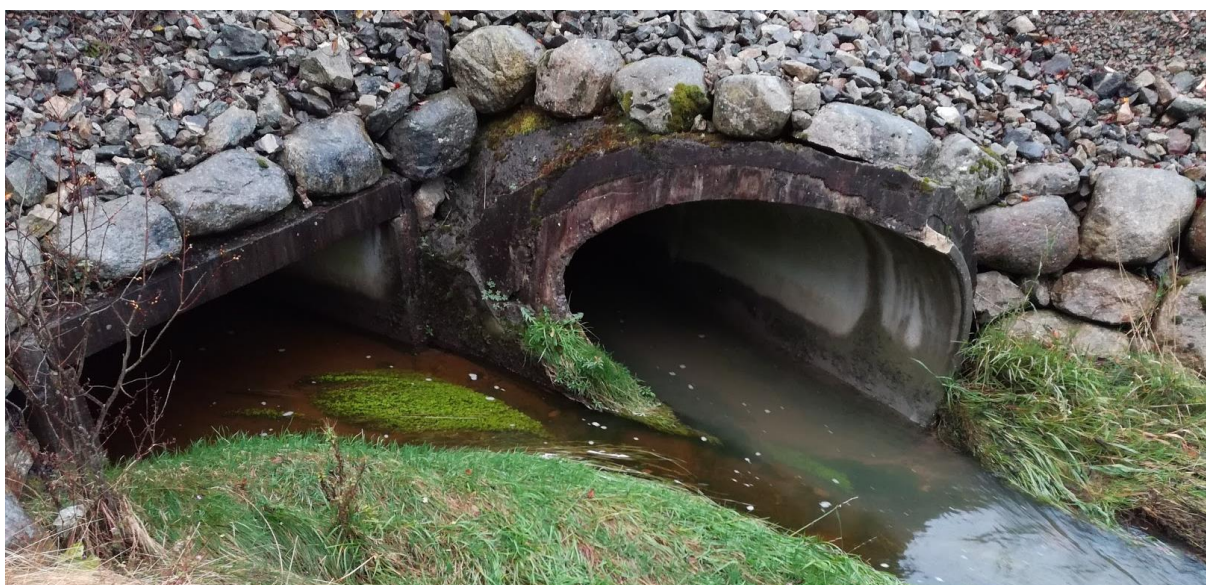
Figur A7: Prøvestasjonen ved rørutløpet: Til venstre er østre rørutløp som leder avrenning fra området mot RV44 og godsterminalen. Dette ble prøvetatt 30.06.17 i den innledende kartleggingsrunden. Til høyre kommer overvann fra Kvål og godsterminalen. Turbiditetesmålinger er tatt fra begge utløp.
