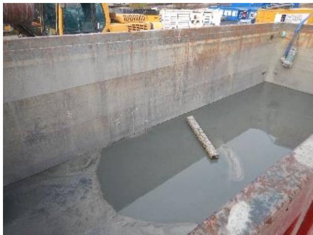
Figur A3. Flere rensekcontainere er satt opp for å sedimentere det finpartikulære boreslammet på riggområdet, men systemet har ikke vært i drift (frem til uke 45), og massene er blitt kjørt på Bjellands deponi.
