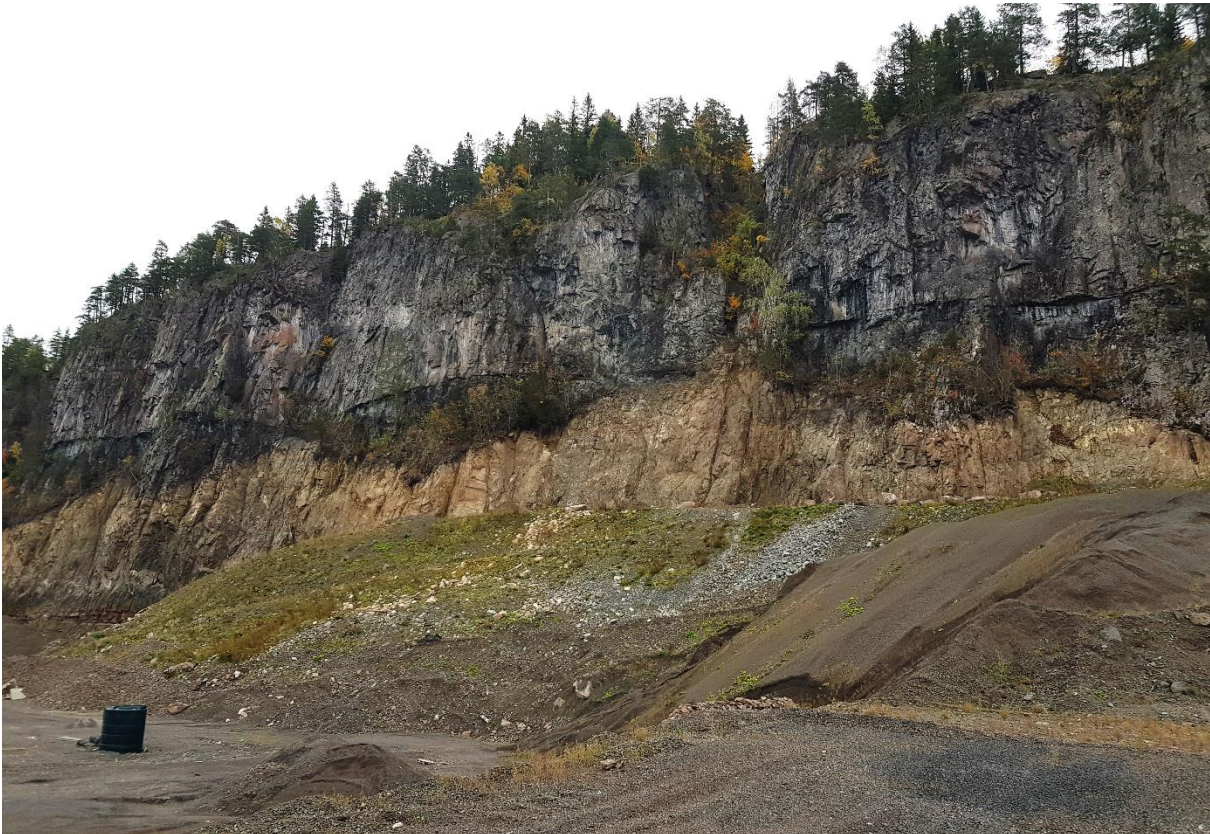
Figur 5.5. Bilde av den vestvendte bergveggen som ligger sentralt i planområdet. Bildet viser hvordan den skogkledde rasmarka som inngår i naturtypelokalitetene 2) og 3) nå er fjernet. Dette området er synlig som et gult felt på bergveggen. Dette inkluderer lokaliteten for barlind i lokalitet 2). Kun et lite område utenfor bildet helt i nord består, Lokalitet nr 3. Kløften der sjakten er tenkt plassert vises noe til høyre på bildet. Foto: Multiconsult.
